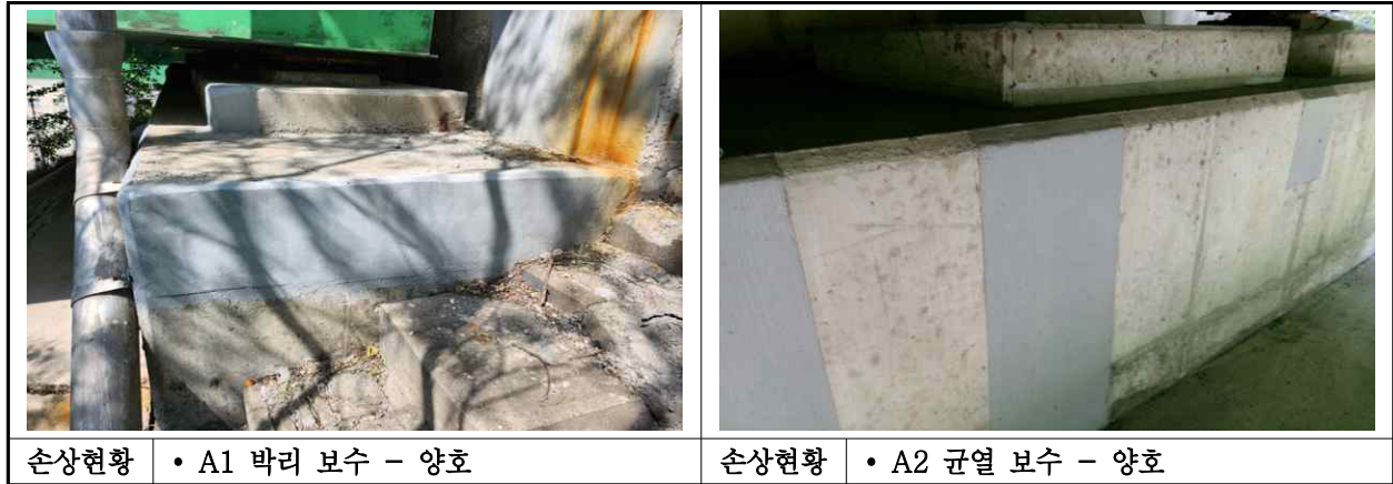
【사진 1.3.9】 교대 손상현황(계속)
