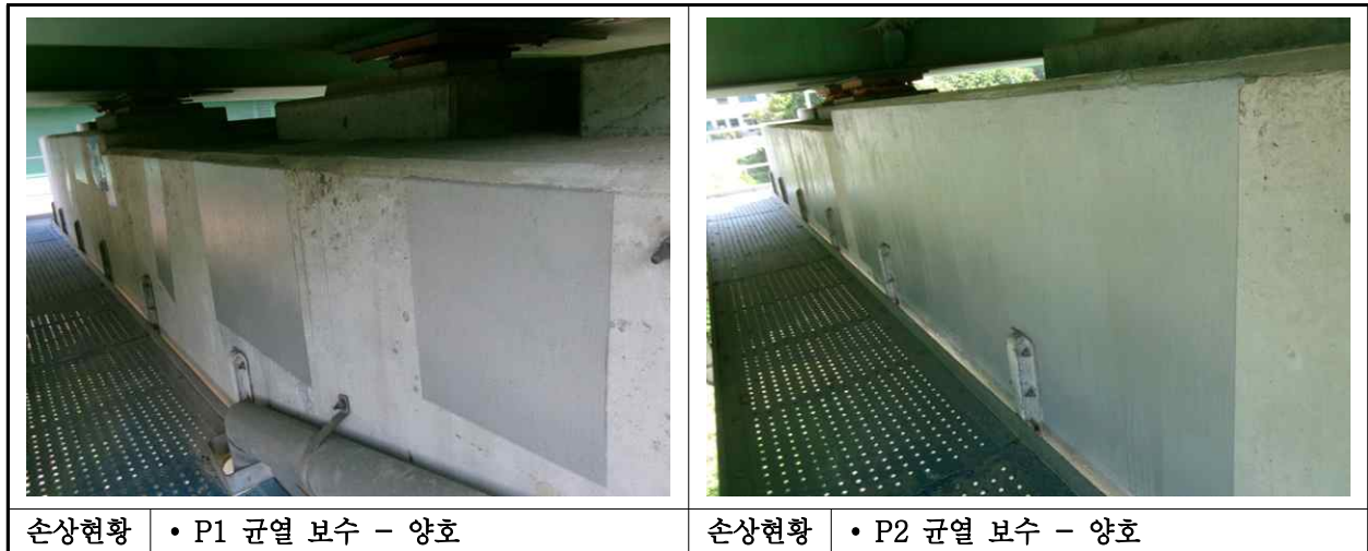
【사진 1.3.11】 교각 손상현황(계속)
